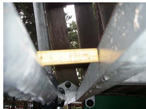
Öppning vid golv på klätterställning där barns fot kan fastna.
