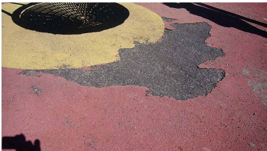
Gummimatta som har åldrats och slitits sönder. Den stötdämpande förmågan har försämrats.
