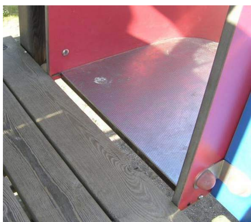
Öppning vid startdel på rutschbana där barns fot kan fastna.
