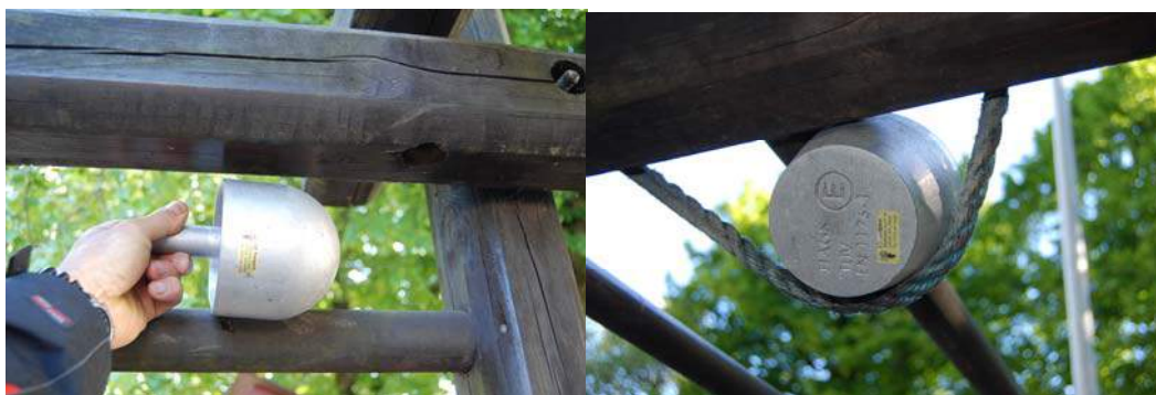
Ställen där barn kan fastna med huvudet på flera ställen i klätterställning. Ett barn kan här komma igenom med kroppen men inte med huvudet och riskerar att bli hängande i huvudet. Provsonden till vänster motsvarar ett barns bröstorg och provsonden till höger ett barns huvud.
