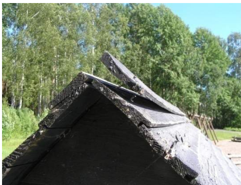
Ruttet och trasigt tak med utstickande delar.
